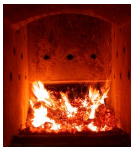
La chaudière Schmid bénéficie d'une forte masse réfractaire garante de bonnes températures de combustion même avec des bois humides ou en basse charge, photo FD
