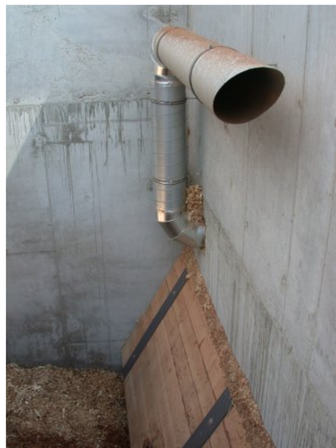
Le local vériers de la chaufferie est ventilé contre les accumulations de CO en points bas, et éjecte de l'air chaud de la chaufferie vers le silo qui lui-même se ventile et ne condense pas, photo FD
