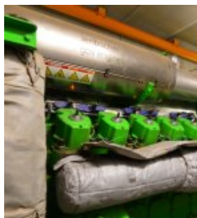
Moteur de cogénération Jenbacher installé en Bretagne, photo Frédéric Douard
