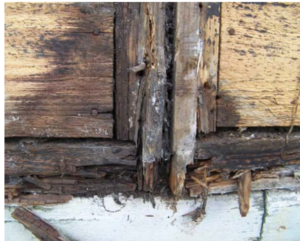
Figure 4 : Pourrissement du bois dû aux exfiltrations d'air dans une maison à ossature bois. Source : Afordex.
