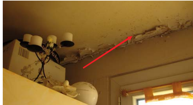
Figure 3 : Écaillage de la peinture au niveau du pont thermique entre le mur et le plafond.
