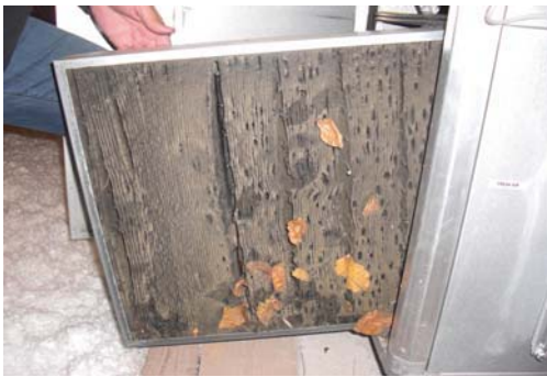
Figure 1 : Filtre d'arrivée d'air neuf encrassé.
