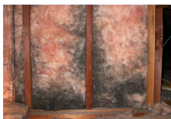
Isolant dégradé par l'humidité
