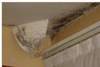
Moisissures au plafond
