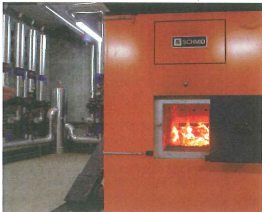
La chaufferie communale
